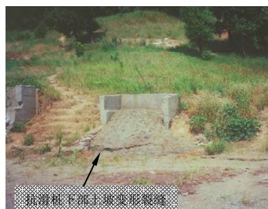
图 6 边坡加固桩下部边坡局部变形
